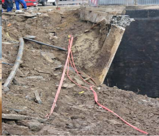
Fig. 8- Rețele utilitare deteriorate
