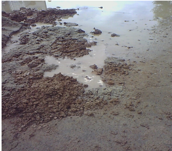
Fig. 5- Apă staționată pe stradă
