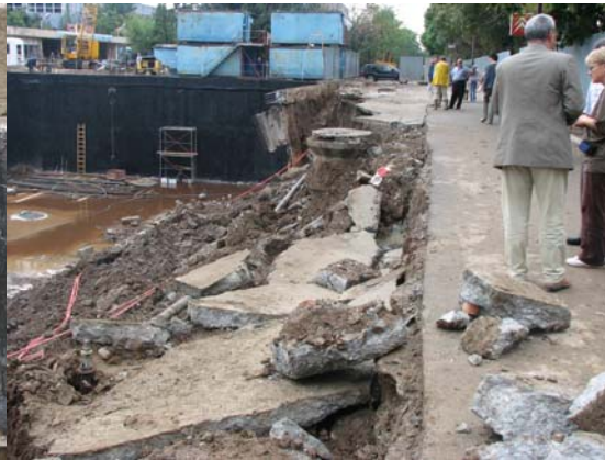
Fig. 10-Sistemul rutier distrus si căminul canalizării
